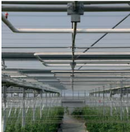
Système de chauffage au plafond نظام التدفئة السقف
