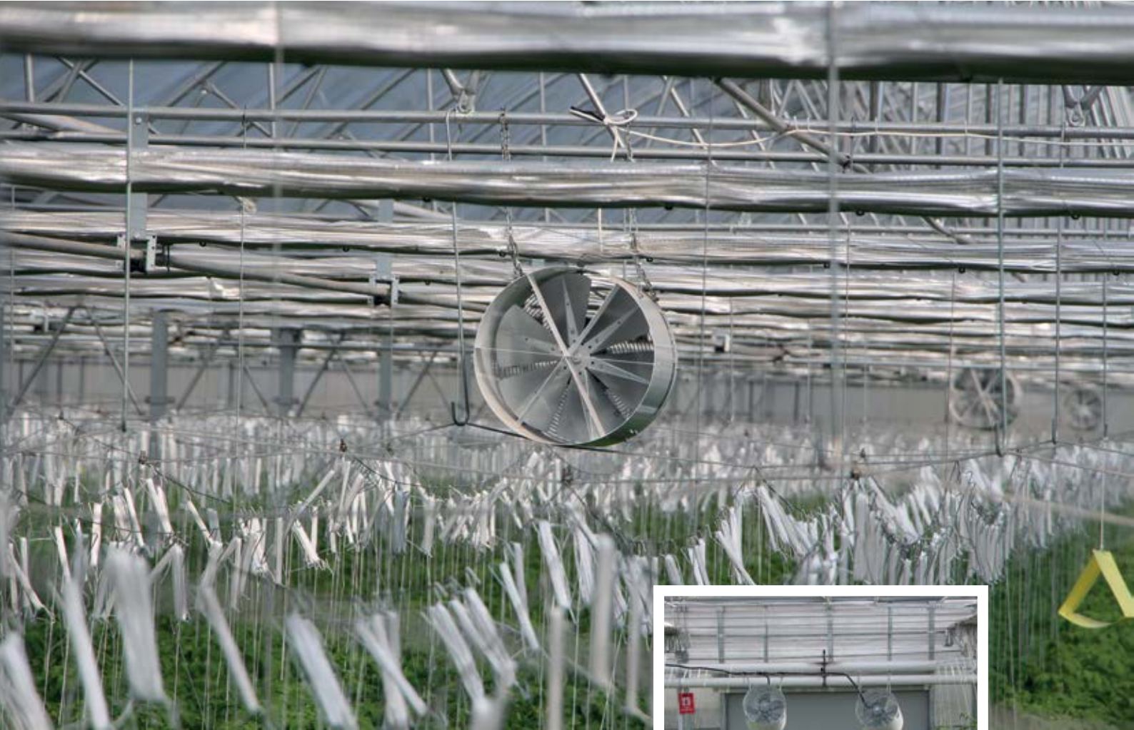
Ventilateurs de circulation
